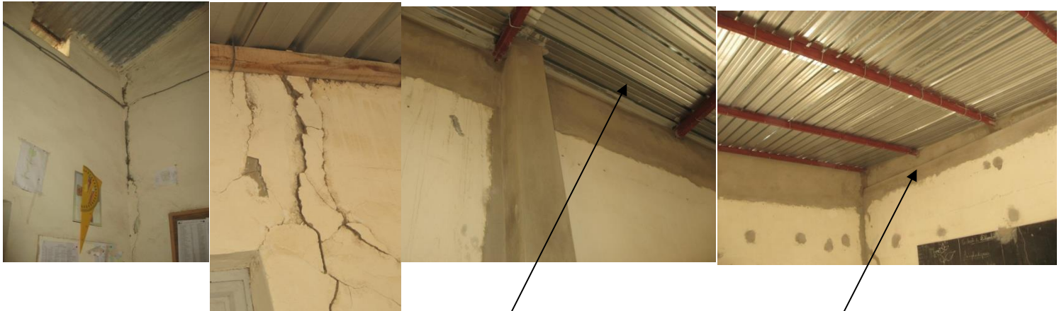
Zustand 2018 Risse in den Wänden.
